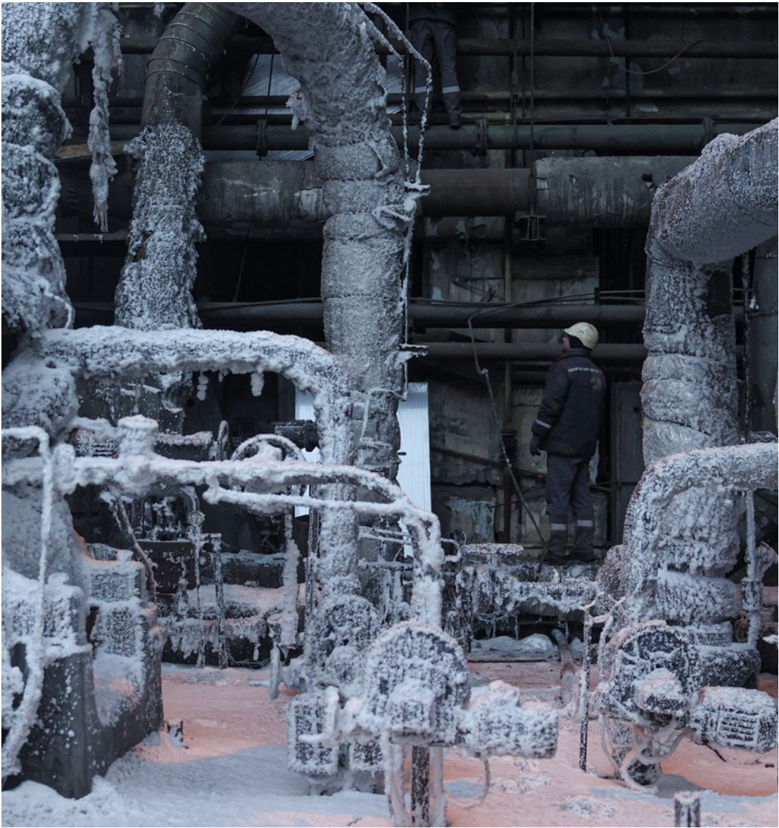
En ansatt undersøker skader ved en ukrainsk kraftstasjon som har vært rammet av en serie russiske missilangrep, 21. januar 2026. Kreml angriper bevisst sivil kritisk infrastruktur for å svekke motstandskraften i Ukrainas befolkning. Bilde: Roman Baluk / Reuters / NTB
