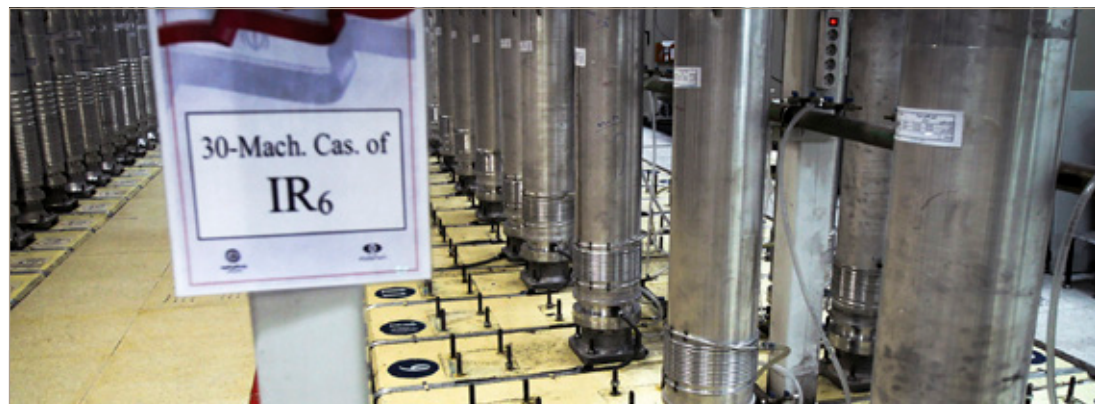
Bilde: Sentrifuger ved Irans anrikingsanlegg i Natanz.
